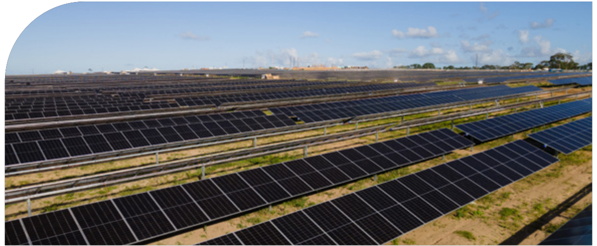
Complexo Fotovoltaico Maravilhas (PE) - Atiaia Renováveis
